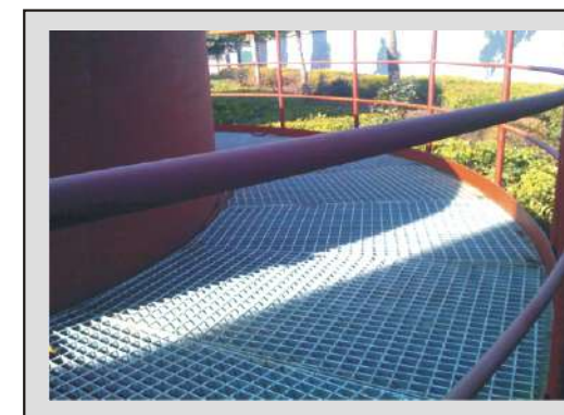
化工厂检修走道
